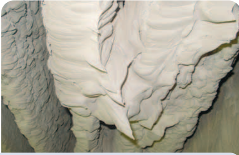
Verschmutzung des Bündels am Eintritt des 3. Zuges nach ca. 700 Betriebsstunden
