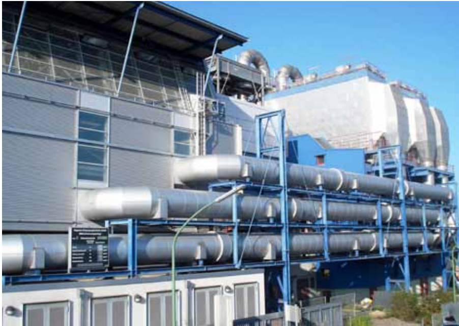
Rauchgasreinigung und E-Filter
